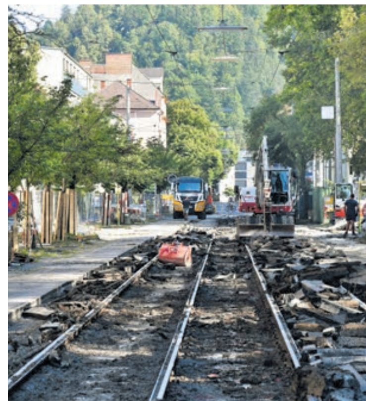
▲ Sommer-Baustelle. Neue Schienen, ein zweites Wartehäuschen, mehr Sicherheit – das alles gibt es nun in der Theodor-Körner-Straße.
